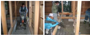
地盤を固める地業 ていねいに組まれた鉄筋に生コンクリートを打つ
