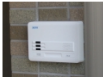
最新のセキュリティ。カードキーシステムが採用されています。
