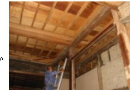
小舞壁(こまいかべ)。防音・調湿効果が高いので、残せるところは極力残しました。
