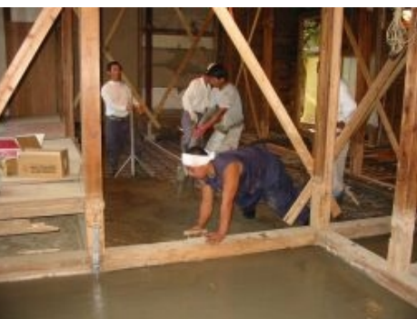
土間に生コンを流し込み、これで基礎の補強が完成しました！
