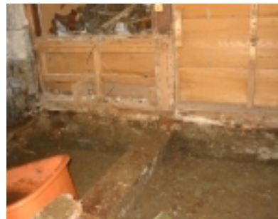
土台の腐敗が進み、半分以上は腐って土になってしまった状態だった。
