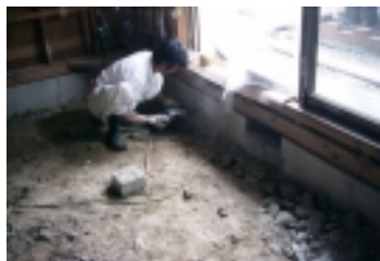
①床の部分を全部取り外して、土間を表します。それから工事が始まります。
