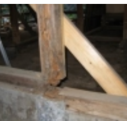
腐って浮いてしまった柱
